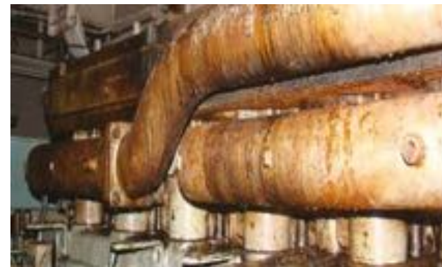
배기시설 전체가 단열처리 되지 않음
