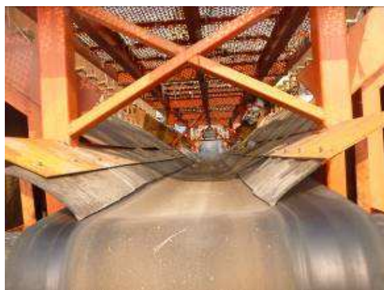
化肥通过铁筛网漏入皮带机
