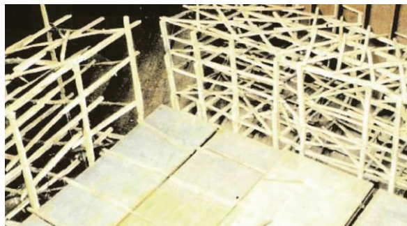
図表 12.15: 脆弱な木製の枠組み
