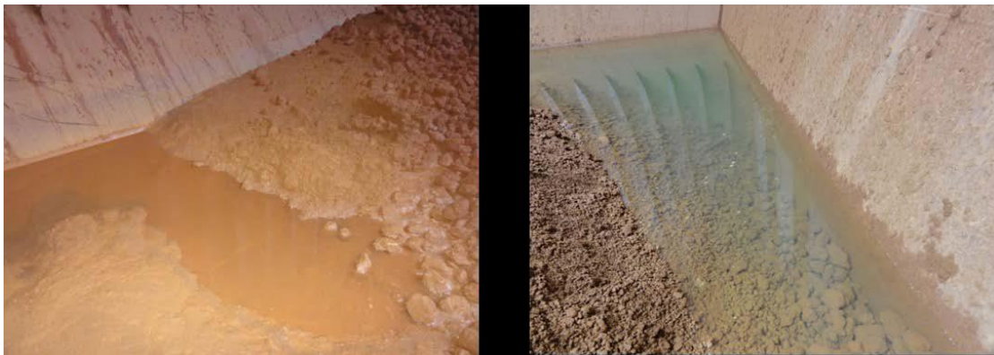
Acumulación de agua alrededor de las periferias de estibas de bauxita
